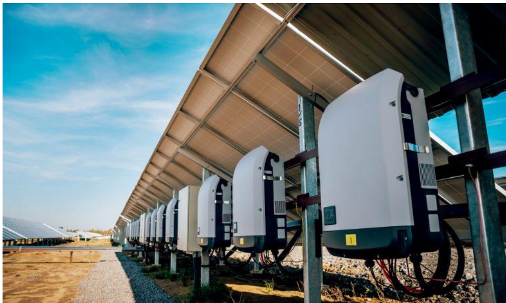
Zdj. 4 Przykład inwerterów na farmie fotowoltaicznej
